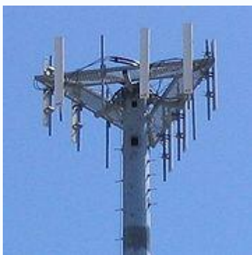
Антенна базовой станции на мачте
